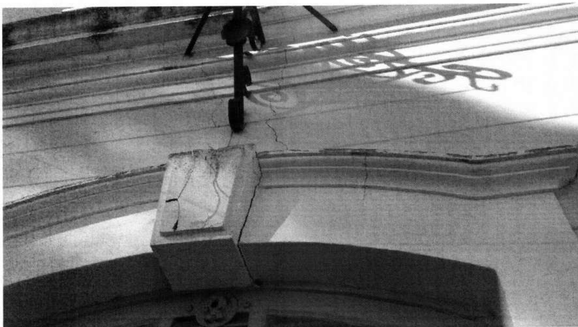
Patologia: Fachada do prédio com uma grande rachadura.
