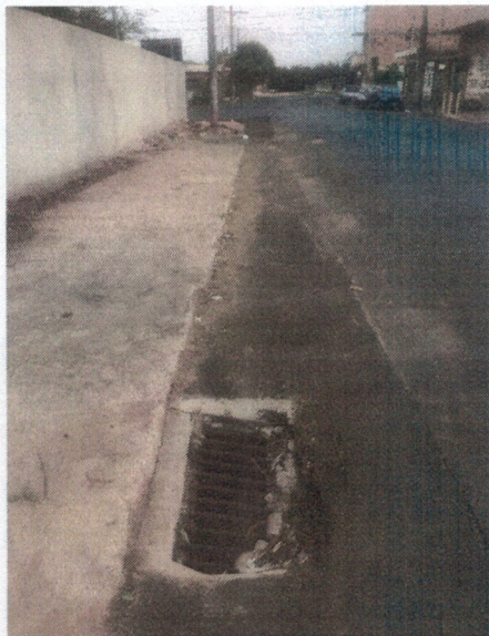
Boca de Lobo Rua João Simão x Av. Arcyr G. Barcellos
